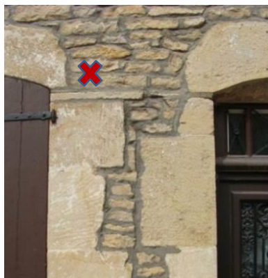
Joints au ciment gris interdits
