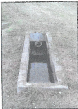
Canal de comptage entrée
