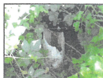
Exutoire dans fossé
