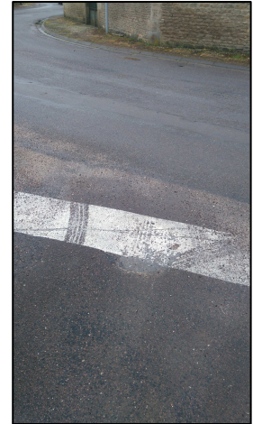
Regard n° 02.2 Stop ruelle Avril, Regard très goudronné et sous le marquage
