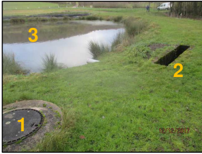
Poste d'alimentation (1) Canal d'entrée (2) 1 ère lagune (3)
