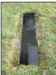
Canal de sortie
