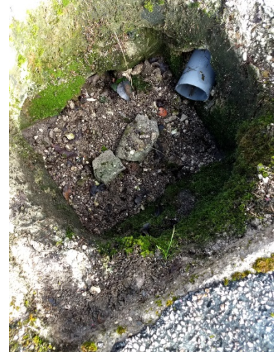
Grille G2 en mauvais état
