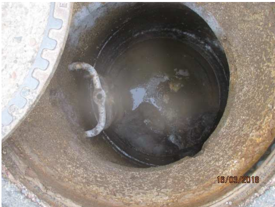
R15 : plein d'eau suite à la montée en charge du réseau lors de l'arrêt de la STEP
