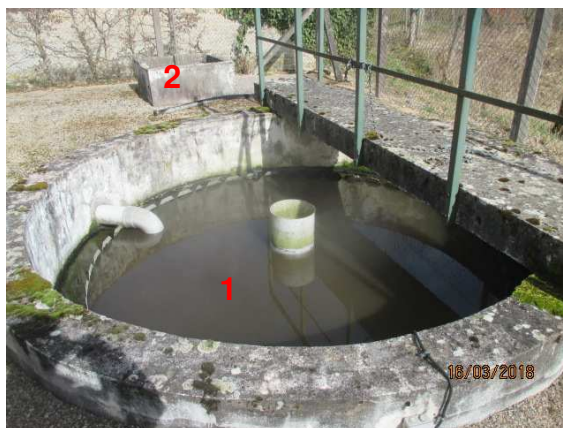
Clarificateur (1) et sortie des eaux vers l'exutoire (2)
